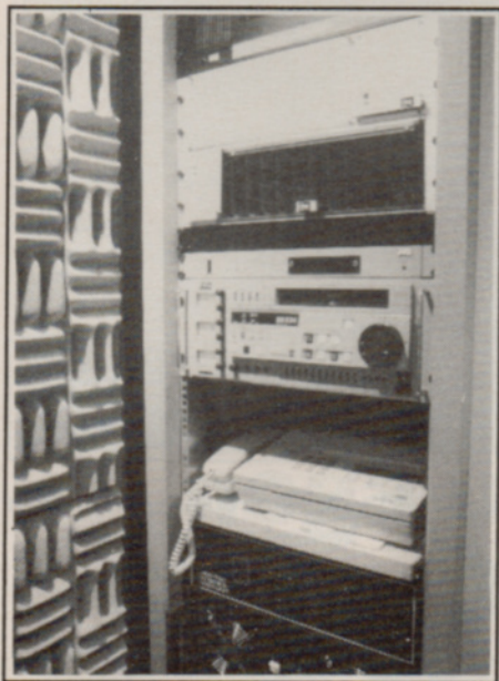
Rackskåp i maskinrummet med bl a fördelnings-förstärkare och videobandspelare.
